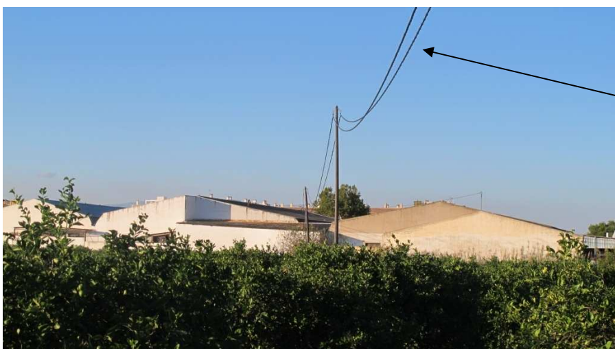
Línea Aérea Baja Tensión
