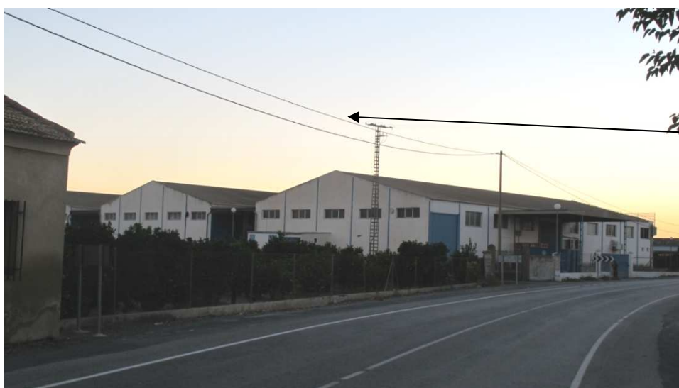
Línea Aérea Baja Tensión
